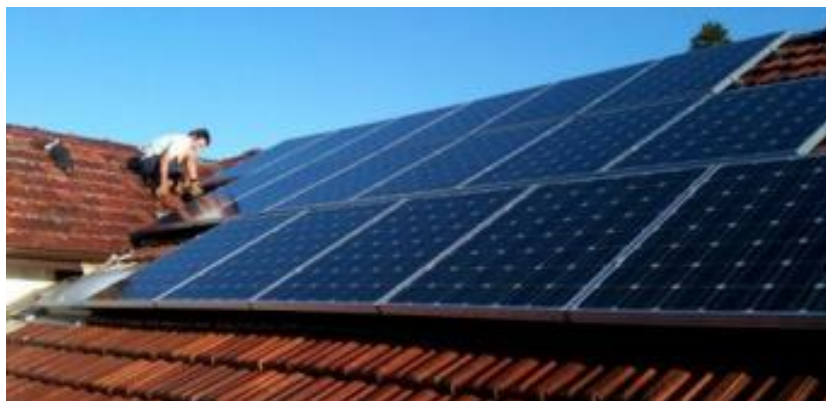
Figura 1 – Montagem de um sistema fotovoltaico
