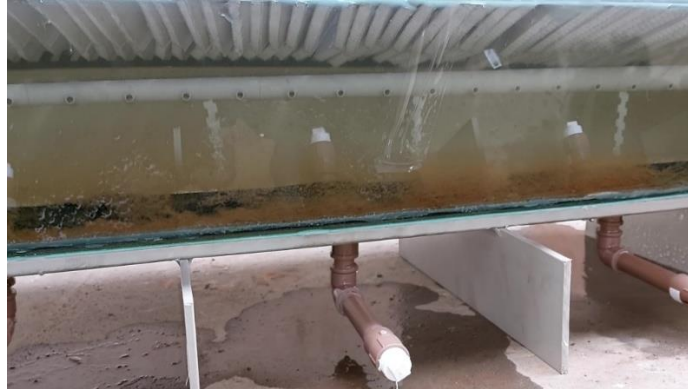
Figura 121 - Deposição de lodo no fundo do Decantador após alguns minutos de operação.
