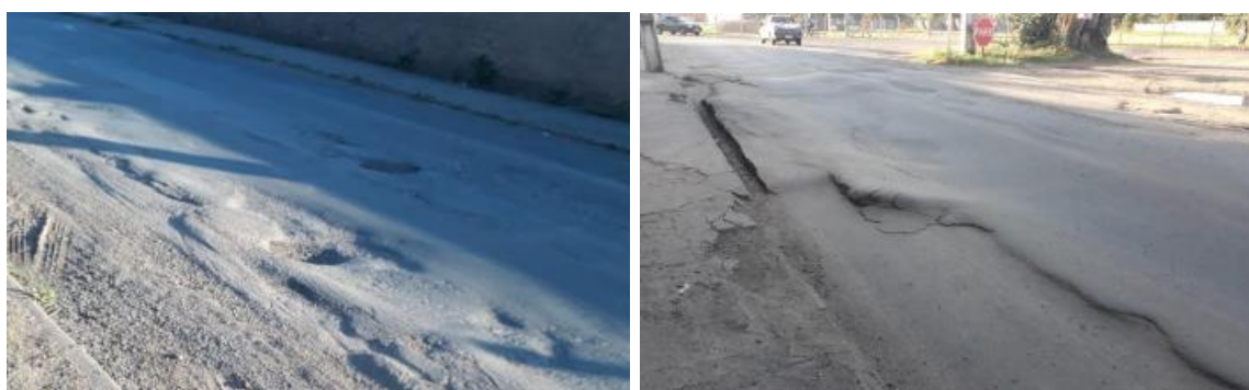
Figura 7 – Revestimento asfáltico danificado.
