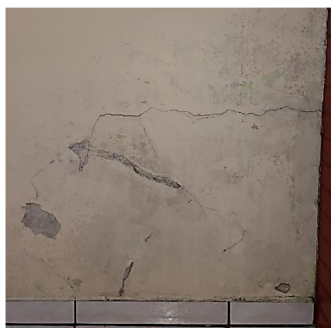
Figura 3 – Fissuras, manchas e descascamento na parede da residência
