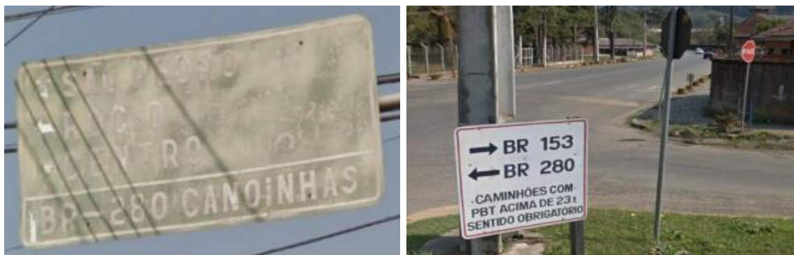
Figura 5 – Sinalização vertical danificado / interferindo no campo visual
