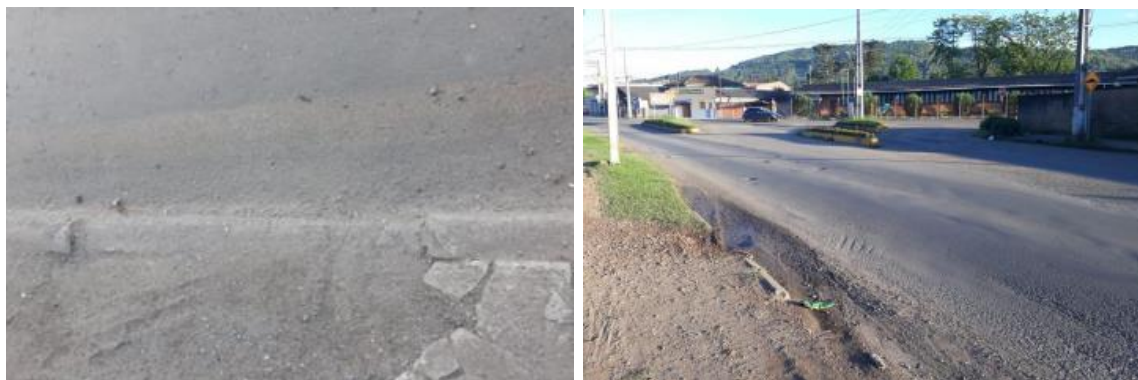
Figura 6– Sinalização horizontal danificada ou inexistente.
